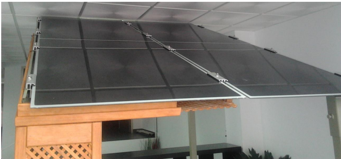
Figura 3. Ejemplo de instalación fotovoltaica.
